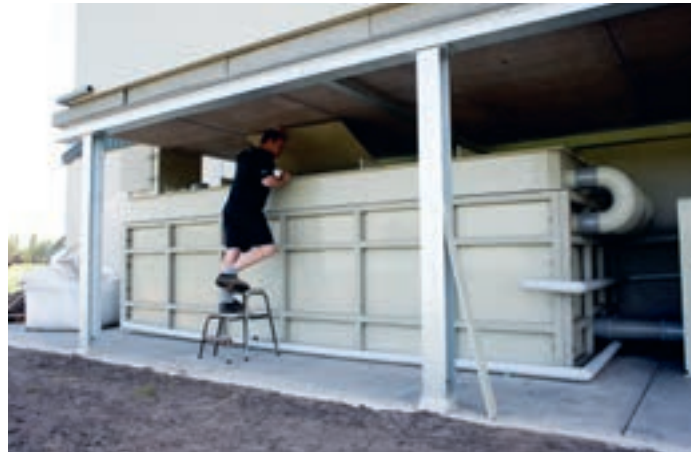
De ILVO-bevindingen leren dat een nauwkeurige opvolging en tijdig onderhoud van het luchtbehandelingsysteem noodzakelijk is om een goede werking te verzekeren.
